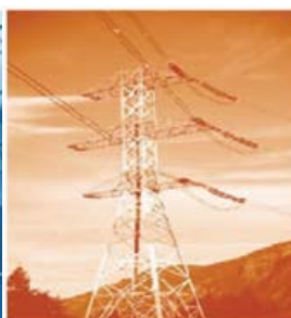
Hệ thống điện
